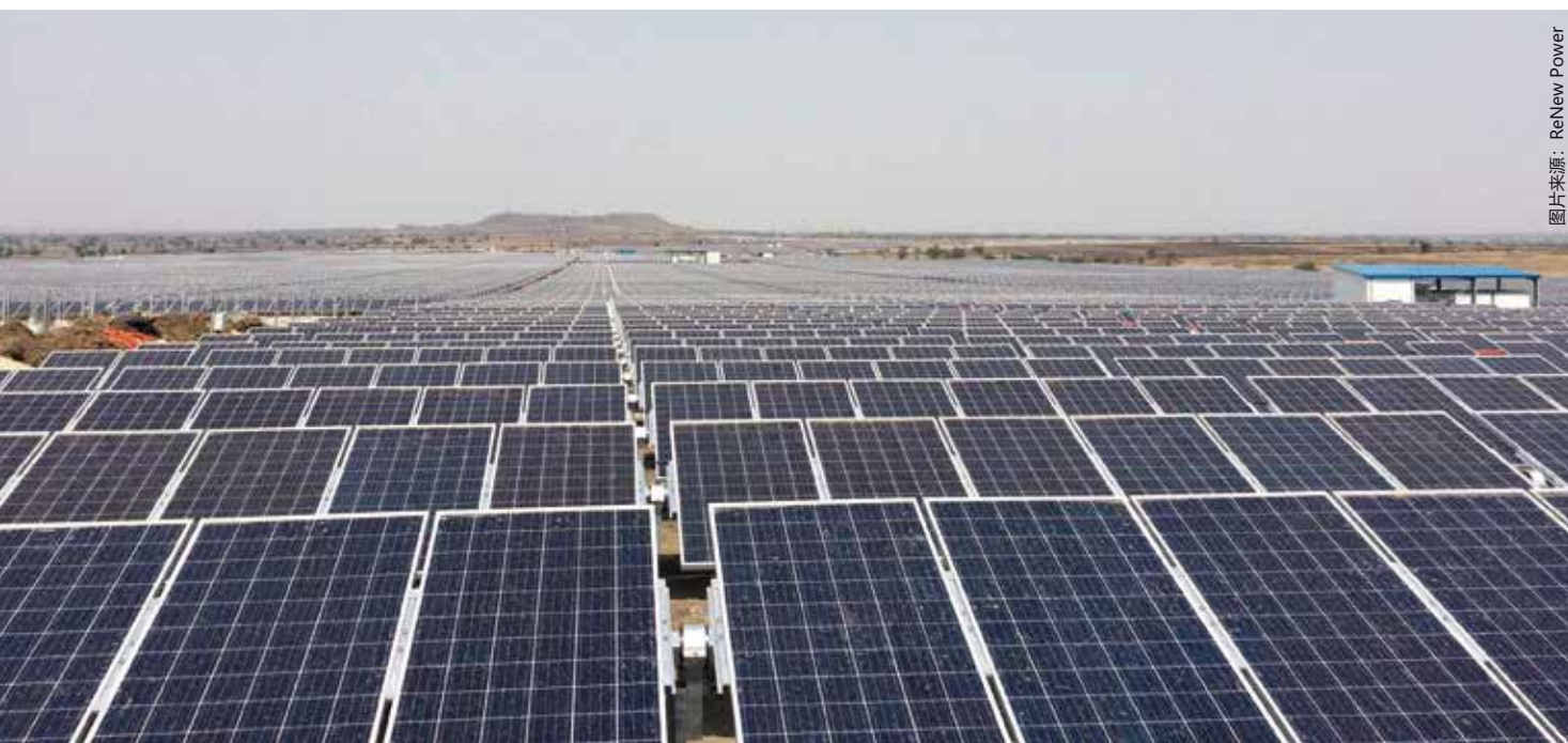
143MW印度特伦甘纳邦ReNew Power项目
