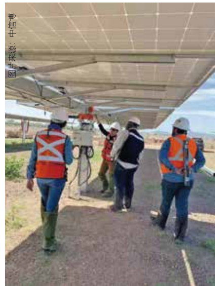
墨西哥167MW Benjamin Hill项目使用了中信博的天智跟踪器
